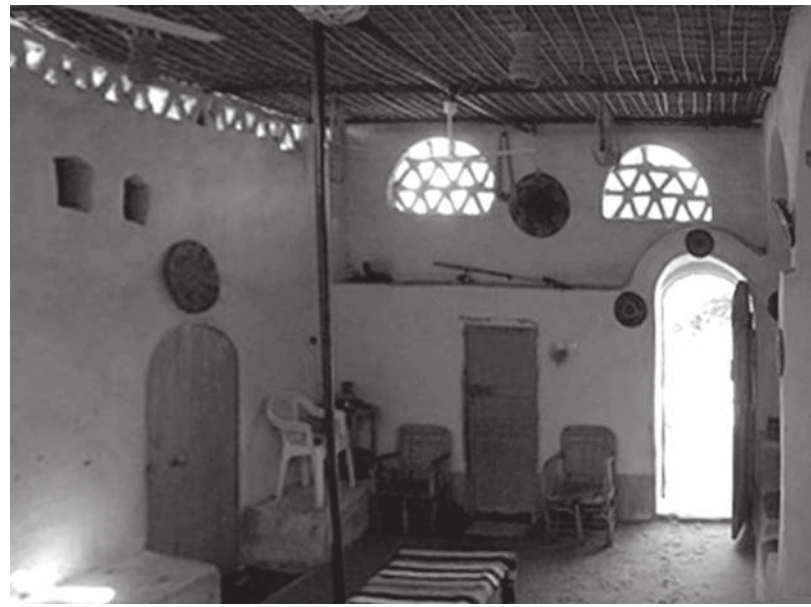
Curtea centrală acoperită cu un tavan nou din stuf. The central courtyard covered by a new reed ceiling.
